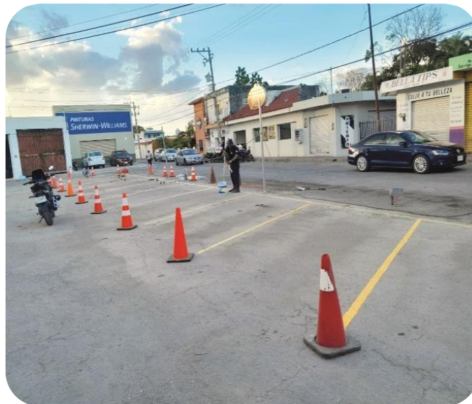
Instalación de señalamientos de tránsito en distintas partes de la cabecera municipal y comisarías.
